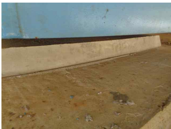
P5-Sh2 받침물탈 균열 (0.1mm/0.2m×2EA)
