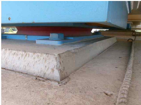
P2-Sh1 받침물탈 파손 (0.1m×0.1m)
