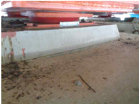
P5-Sh6 받침물탈 균열 (0.1mm/0.2m×2EA)
