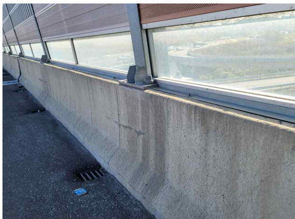
S4 균열 (0.2mm/1.5m×17EA)
