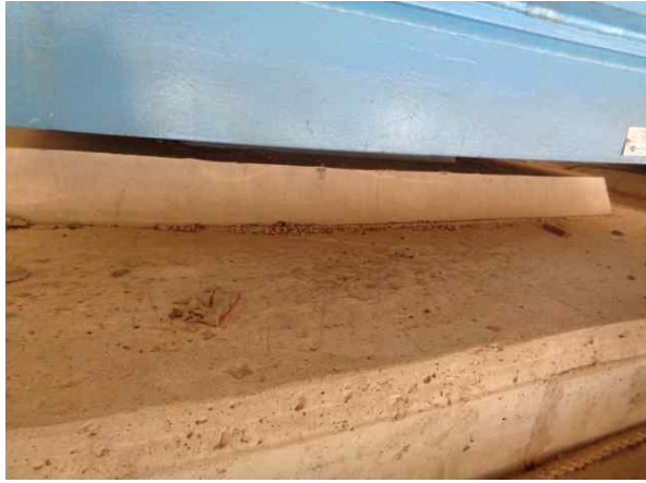
P5-Sh10 받침물탈 균열 (0.1mm/0.2m×2EA)
