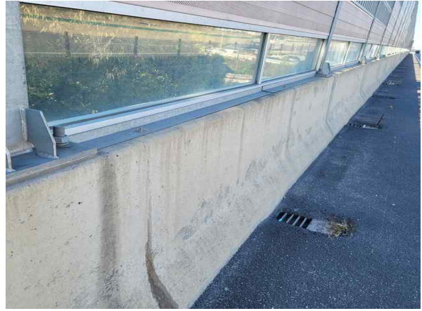
S1 균열 (0.2mm/1.5m×8EA)
