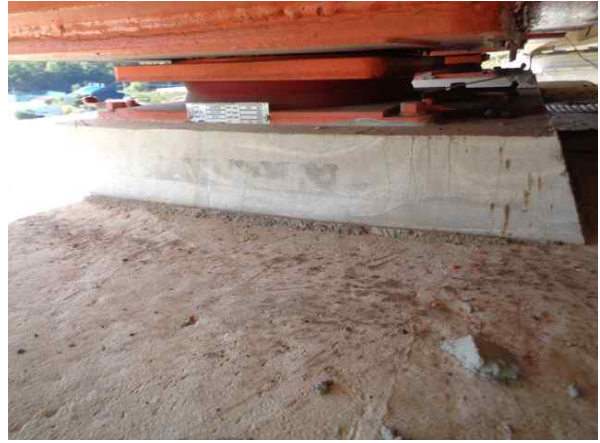
P5-Sh1 받침물탈 균열 (0.1mm/0.2m×2EA)
