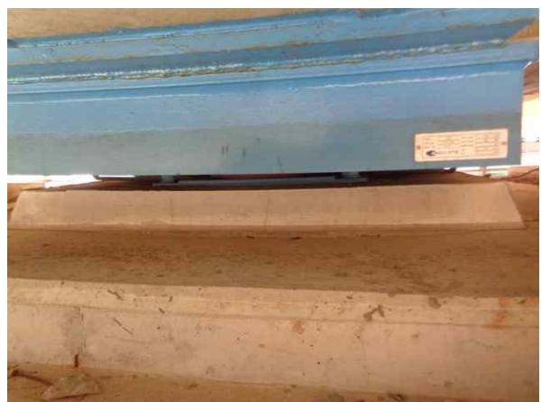
P5-Sh3 받침물탈 균열 (0.1mm/0.2m×2EA)
