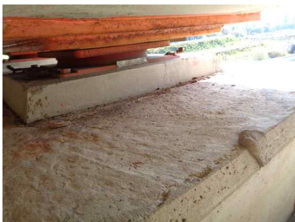
P5-Sh7 받침물탈 균열 (0.1mm/0.2m×2EA)
