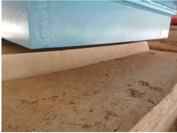
P5-Sh5 받침물탈 균열 (0.1mm/0.2m×2EA)
